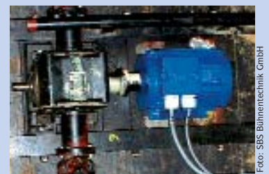
Blick unter den Fußboden: Antrieb des Hinterbühnenwagens in der Semperoper
