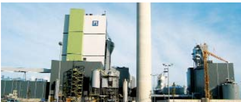
VEM-Antriebe sind im Einsatz, wenn hier künftig 550.000 Tonnen Zellstoff pro Jahr entstehen.
