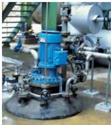
Schachtabwasserpumpe. In Bereichen, in denen explosive Gas-Luft-Gemische auftreten können, müssen explosionsschutzgeschützte elektrische Betriebsmittel eingesetzt werden.
