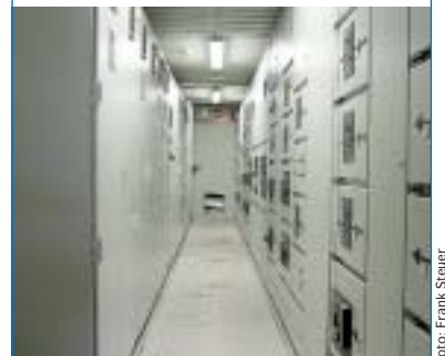
Die Containerschaltanlage hat eine Anschlussleistung von zwei Mal 4.000 Ampere.
