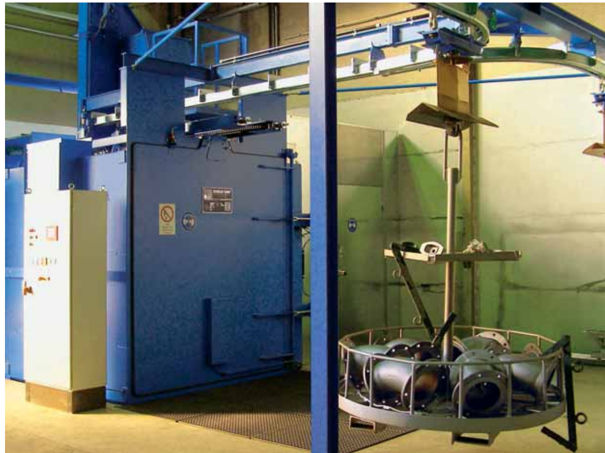
Die neue Einlauf-Hängebahn-Strahlanlage in der Keulahütte
