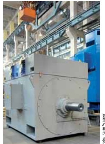
Schleifringläufermotor mit KBAV, 4,5 MW; 6 kV
