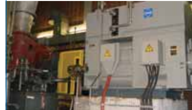
Schleifringläufermotor für SO 2 -Gebläse, Typ DBKAJ 6321-4WF, 2.050 kW, 6 kV
