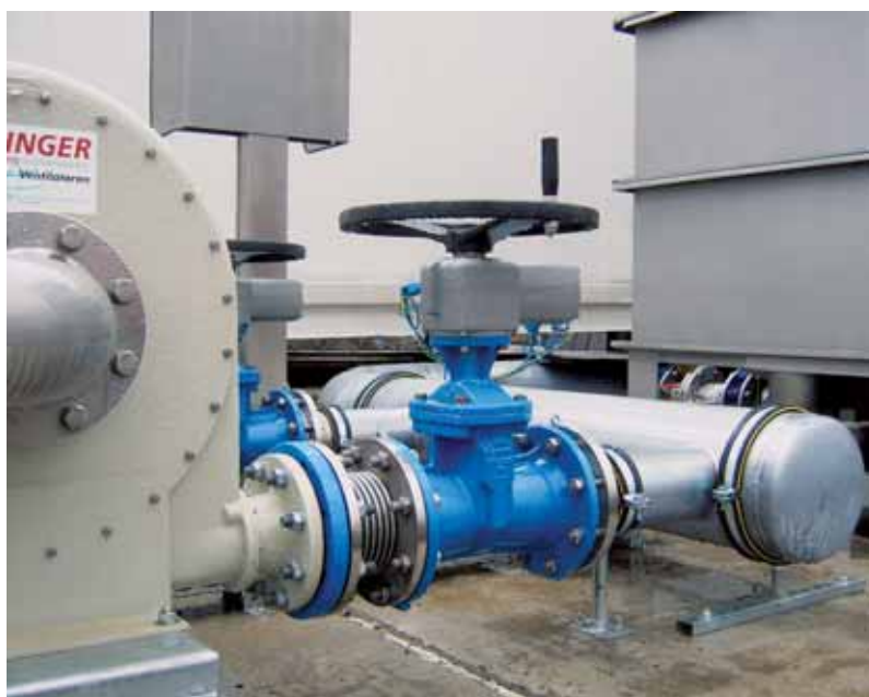
Das Biogas-Blockheizkraftwerk Zittau ist mit Gasschiebern der Keulahütte ausgerüstet.
