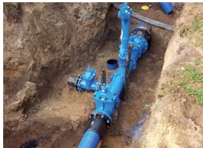
Auch in Zukunft wird das bewährte Produktprogramm der Keulahütte zur Sicherung der stabilen Versorgung der Kunden der Stadtwerke Lübz beitragen und für künftige Baumaßnahmen eingeplant.
